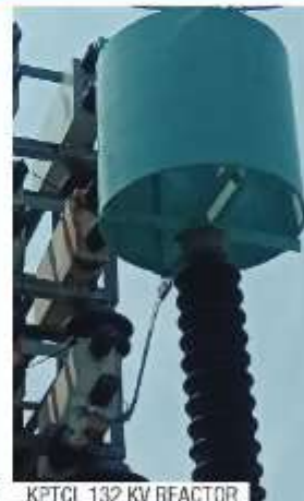
KPTCL 132 KV REACTOR
